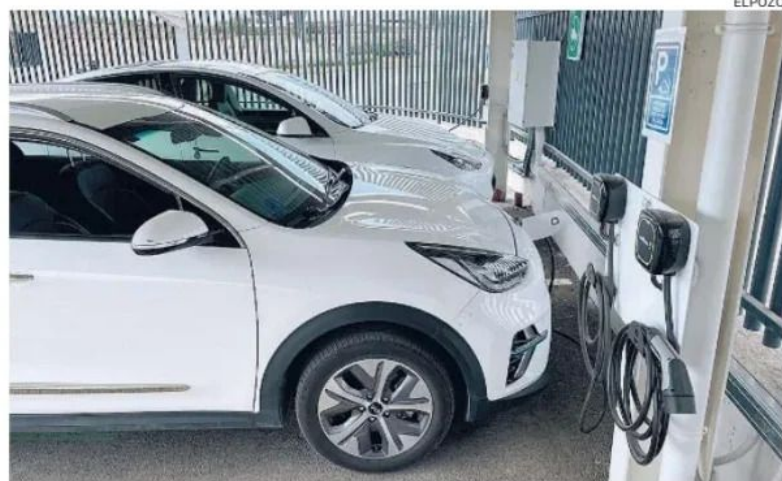
Instalaciones de carga de vehículos eléctricos e híbridos enchufables en Fripozo
